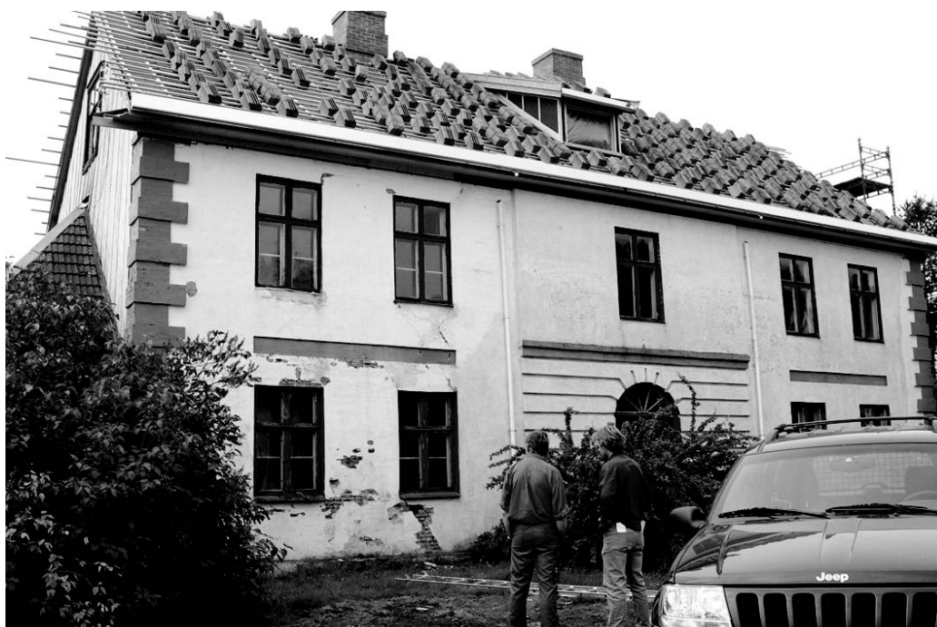
Figur 9.4 Vedlikehold og istandsetting av fredete bygninger kan kreve spesiell håndverkerkompetanse og kostbare materialer. Skatte- og avgiftsfritak kan være stimulerende incitament for eiere av fredete bygninger. Store Løken gård i Løten.
