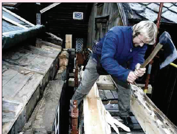
Figur 6.1 Gamle håndverksmetoder er tatt i bruk under istandsetting av gamle hus på Vega.
