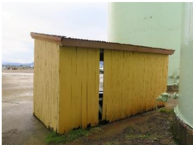
Sykkelskuret mangler et panelbord, sett mot øst.
