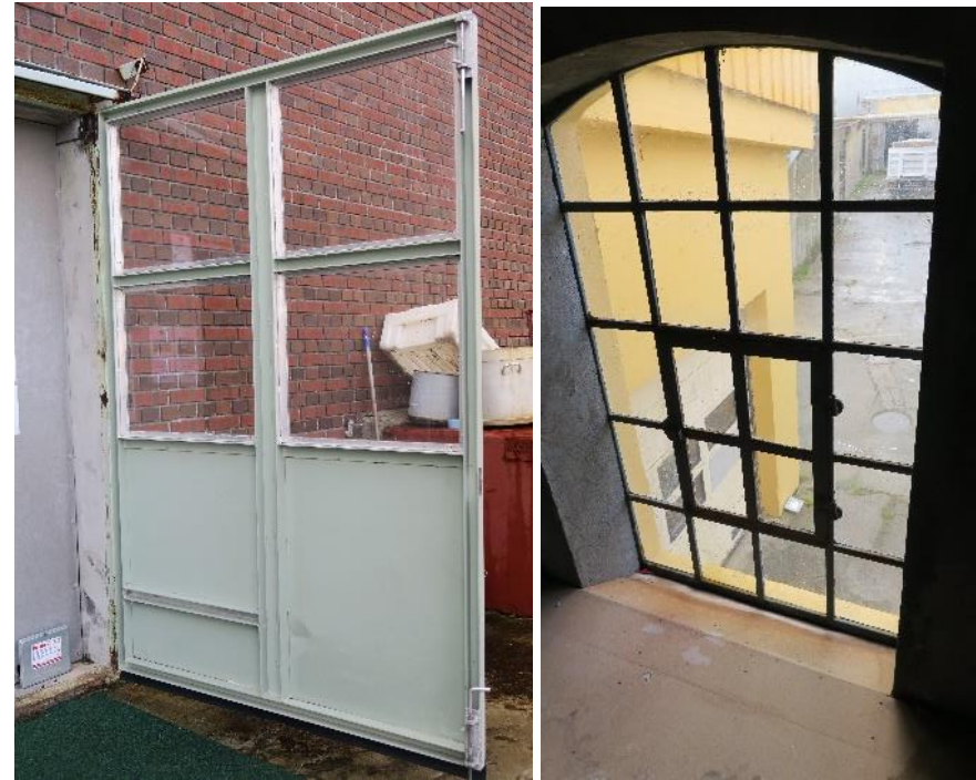
Detalj av dør (tv.), denne er en kopi av original dør. Byggets seks vinduer ble restaurert i 1995, disse er også kopi av de originale vinduene.
