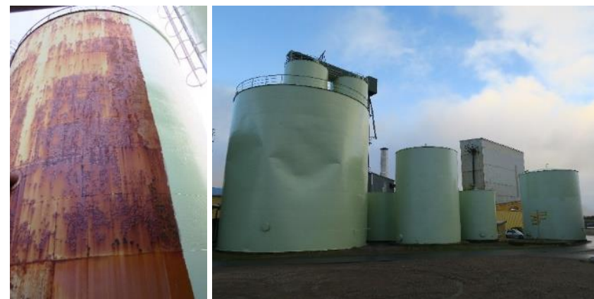
Tv. ved fredningstidspunktet har råstofftank 4 store rustproblemer. Rust må fjernes før tanken kan males ferdig, sett mot sørvest. Th. sett mot nordøst.
