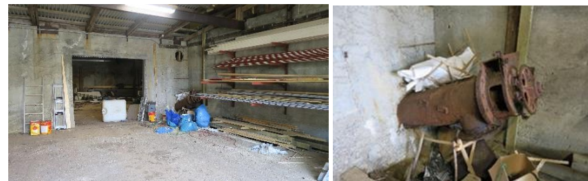
Tv. mateskruen går gjennom betongmuren og ender i transportbandet på andre siden av muren (14.1.1), til høyre for porten, sett mot nordvest. Th. detalj av transportbandet, sett mot nord- nordvest.
