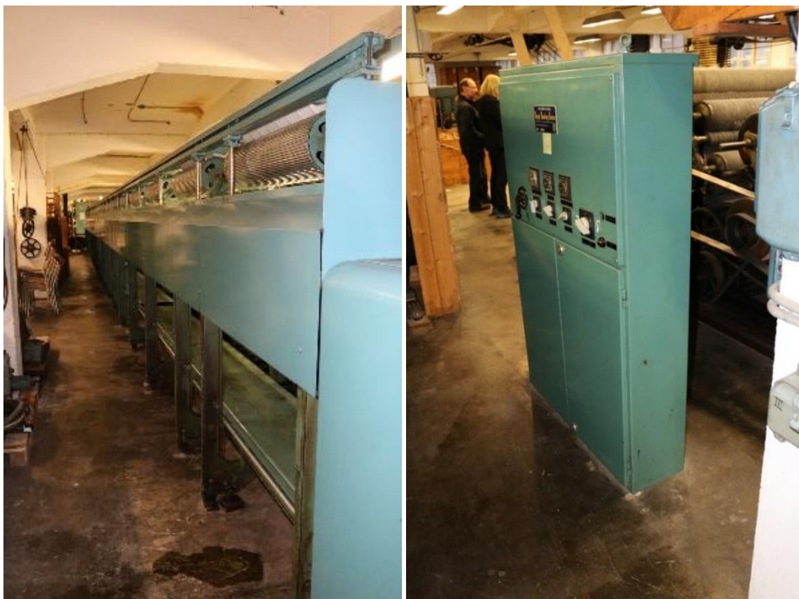
To. baksiden av 6. ringspinnemaskin. Th. en kontrolltavle.
