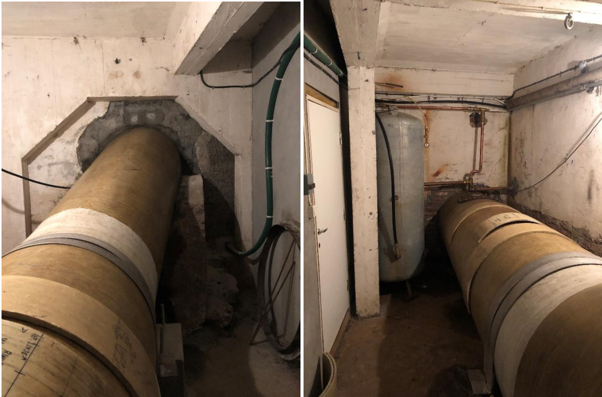
Tv. rørgata (turbindrøet) går inn i spinneribygget og videre til turbinen. Sett fra sør. Th. på motsatt side av rommet forsvinner turbinrøret inn i vegg - mot turbinen. Ved siden av turbinrøret står en trykktank til vannforsyning og sprinkler. Foto: Nils Olai Romsoik-Mannes, Sjølingstad Ullvarefabrik 2019.
