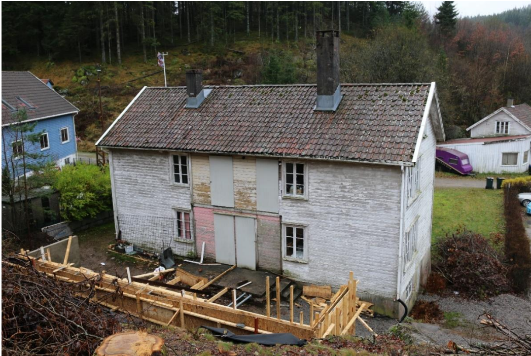
Nordveggen. Det blå huset i bakgrunnen er den tidligere funksjonærboligen som ikke inngår i omfanget. Bak denne boligen ligger det gamle skolehuset. I forkant av bygget ses pågående arbeider med rekonstruksjon av Våningens uthus.
