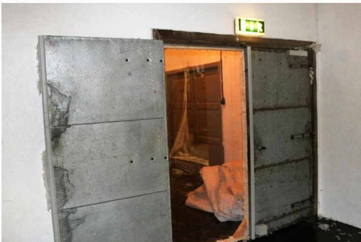
Bildet er tatt fra plyssen, gjennom plexiruta og inn mot gangen.
