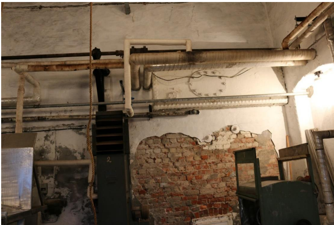
Nordre vegg mot 25. kjelerom har sår. Murpuss har ramlet av og viser mursteinsveggen under.
