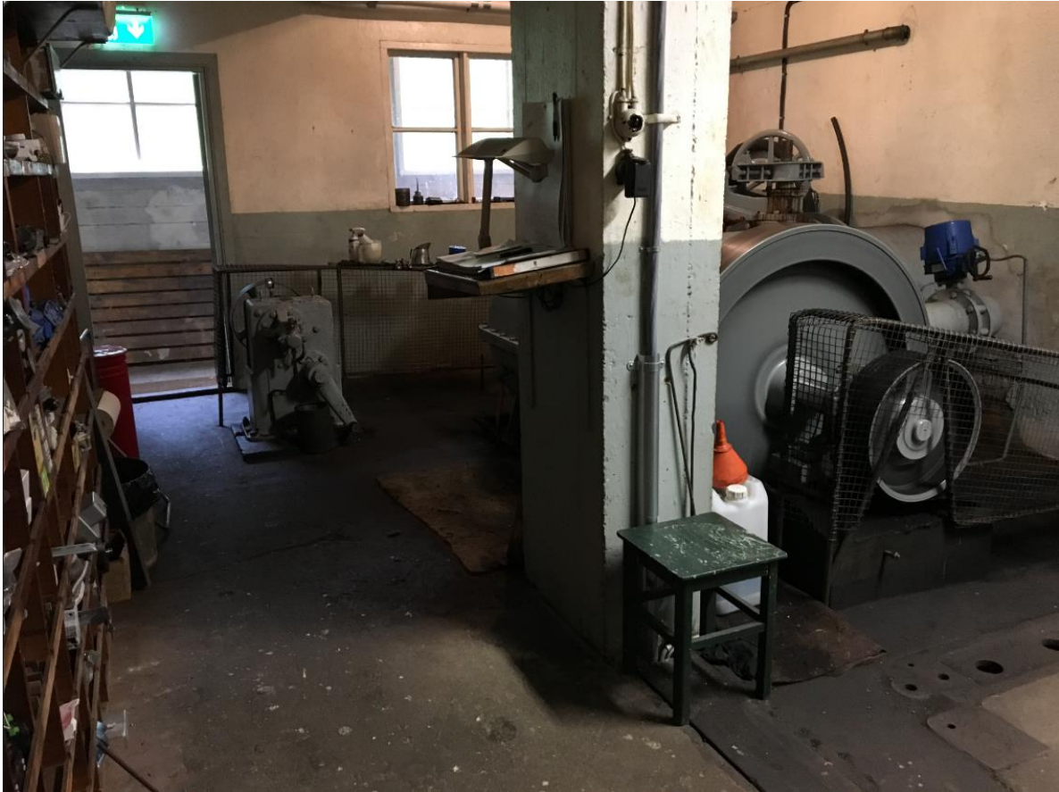
Turbinrommet sett mot vestre yttervegg. Ved døra står den gamle regulatoren for vannmengde (19) til turbinen. Til høyre i bildet, bak søylen er turbinen (18).
