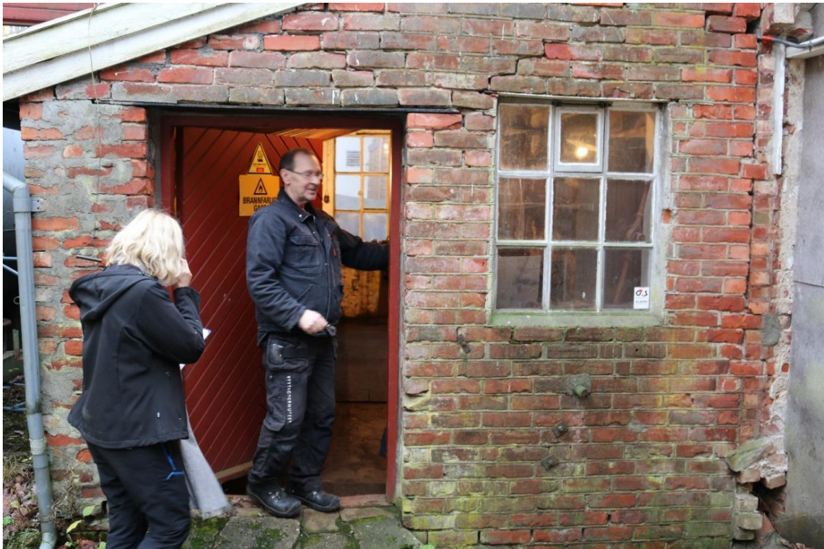
Smias vestvegg bærer tydelig preg av frostskaider og forfall. Sviktende stålbæring over døra.
