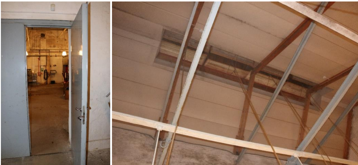
Tv. sett fra våtappretur og inn i fargeriet, mot vestveggen. Th. åpen himling med lufteluke.
