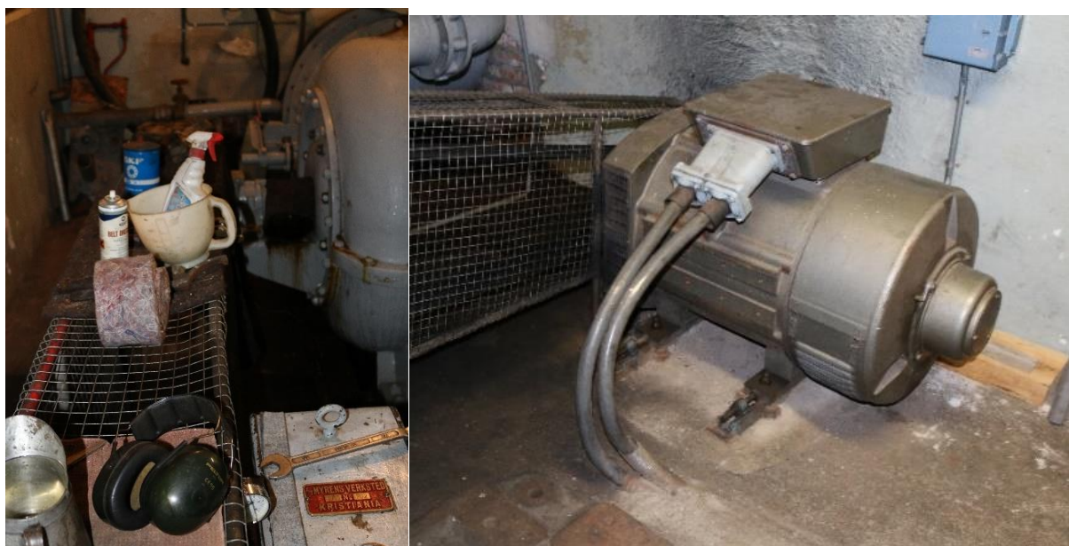
Tv. turbinen sett frå sør. I forgrunnen vises den gamle 19. regulatoren for vannmengde, produsert på Myrens mekaniske verksted, 1917. Th. er vekselsstrømgeneratoren fra 1979.
