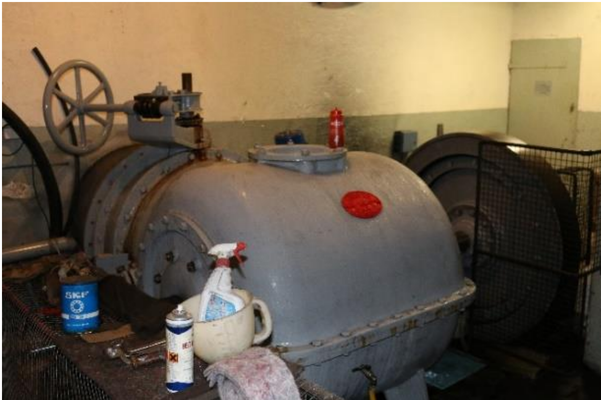
Turbinen sett fra vest.
