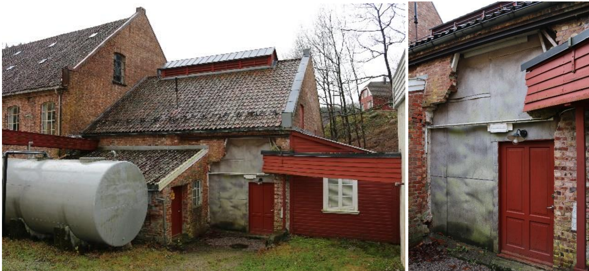
Tv. nordveggen med stort sår etter uttaking av fyrkjelen. Th. detalj av veggens sår omkring døra. Veggen er ikke istandsatt fordi målet er å få kjelen på plass igjen samme vei.
