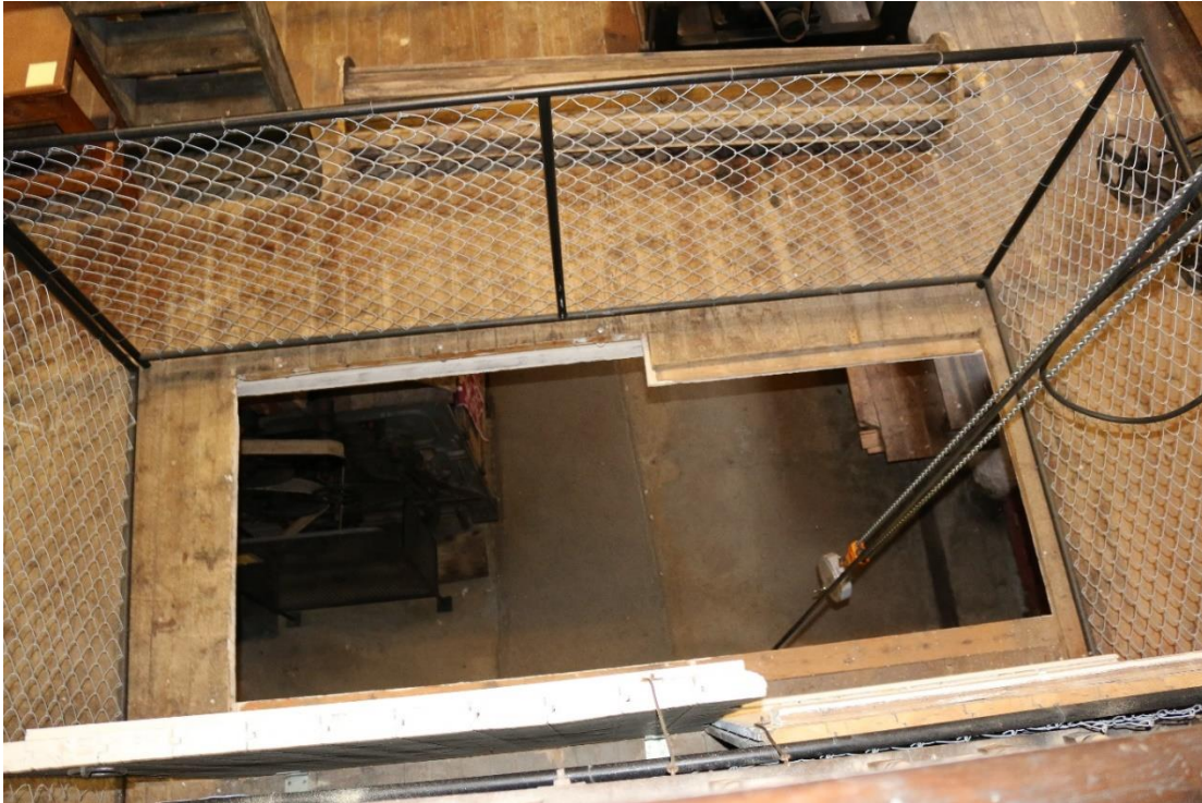
Frakteluke mellom våtappretur og tørrappretur med heisemekanisme (12).
